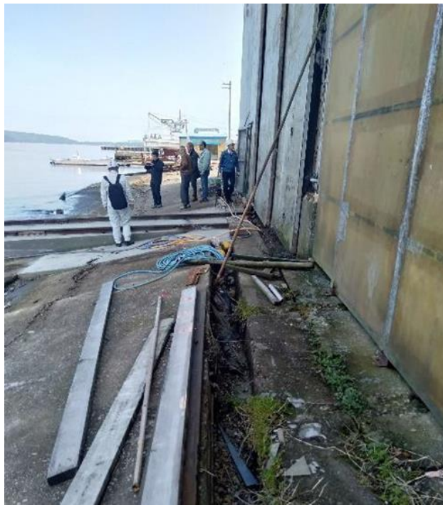
図 4-7 船台コンクリート床版及びレールの沈下
