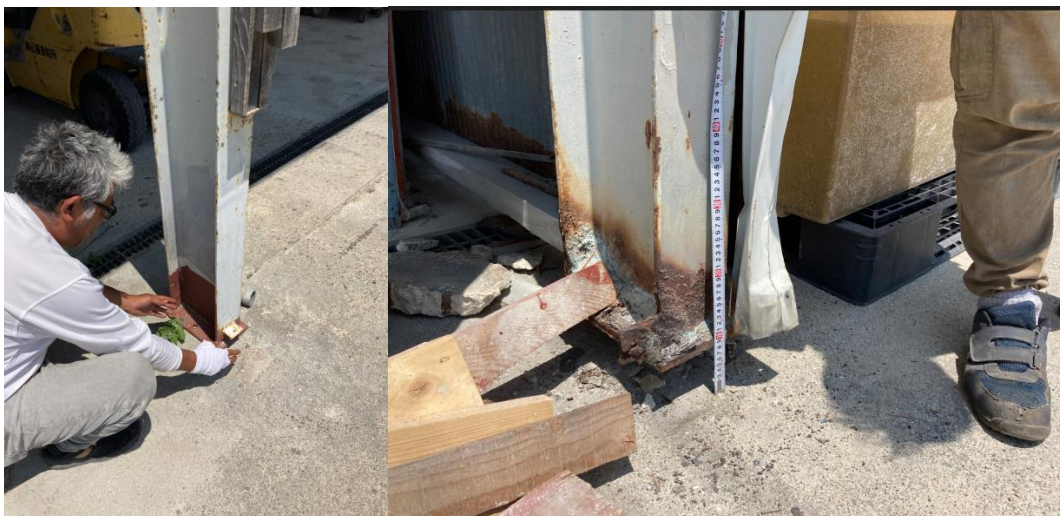
図 4-8 新造船建屋入り口の鋼柱基礎部の剥がれとずれ
