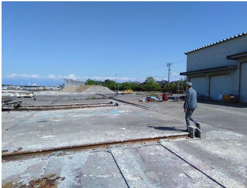
図 4-29 新湊漁協ドックヤード船台ヤード/コンクリート床版不等沈下
