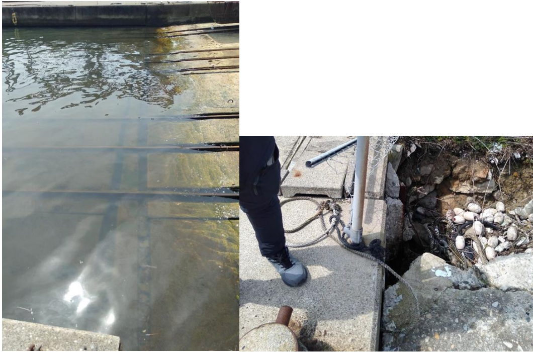
図 4-24 水中部の地盤沈下によるコンクリート床版の開き（陸側及び海側共約 10 cm*2 条）と護岸背面部被災（裏込め部変形に因る陥没）
