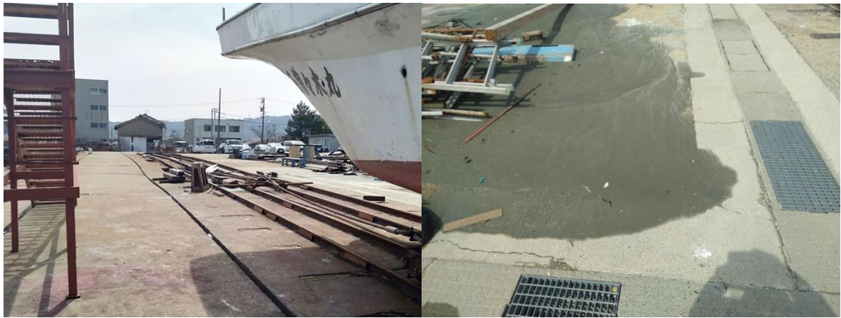
図 4-9 船台コンクリート床版及びレールの沈下及び液状化による床版部噴砂状況
