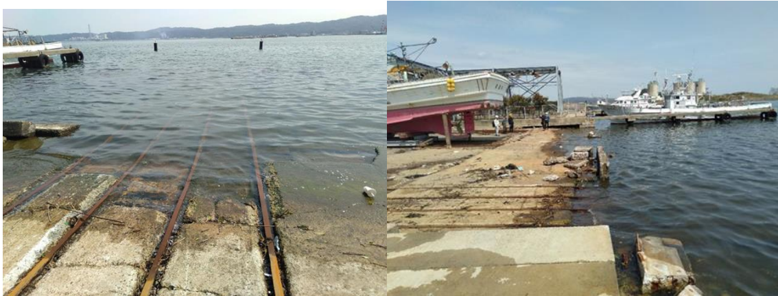
図 4-16 船台レール水中部変形（左屈折）と岸壁ヤード部護岸被災状況（コンクリートブロック割れ、はみ出し他）
