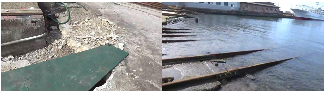
図 4-27 船台上端のコンクリート被害とレールの水際
