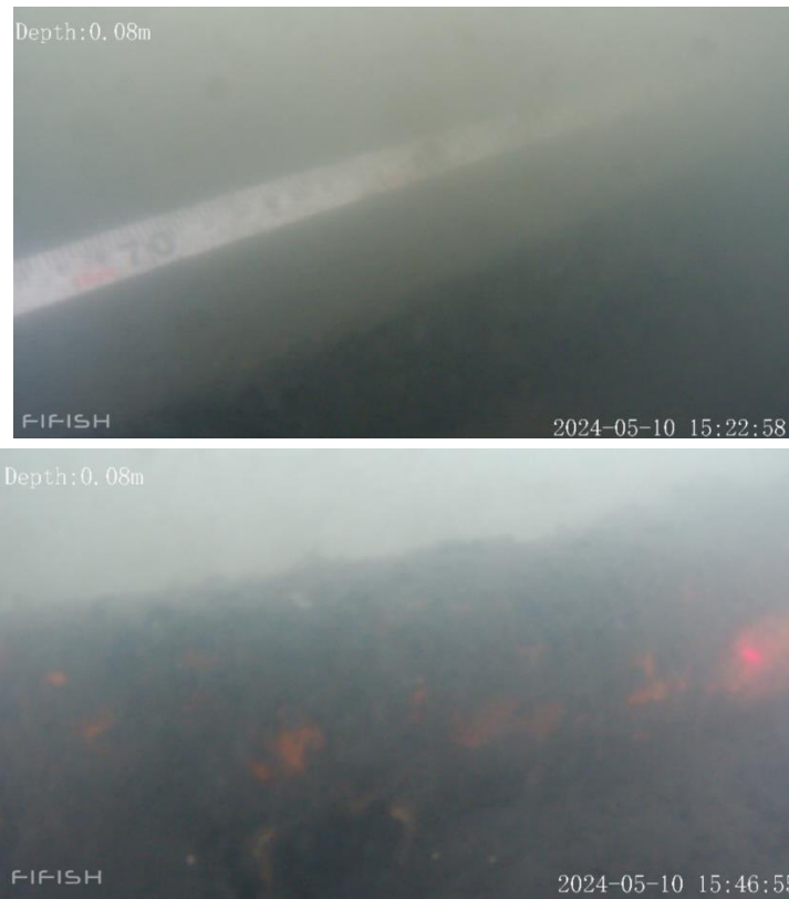
図 4-33 近藤造船 No.3 船台水中部 16.7 m 付近と堆積物除去後のレールの状態
