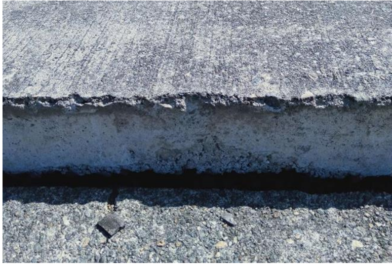
図 4-31 コンクリート床版段差（沈下/約 20 cm）
