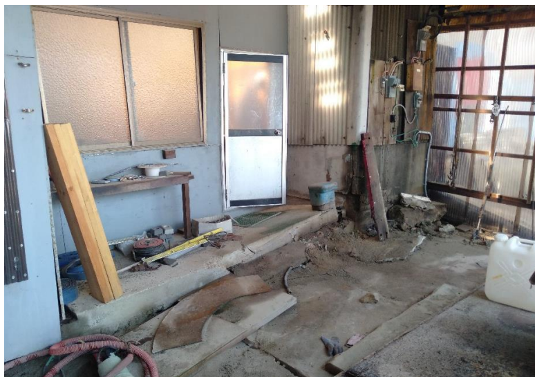
図 4-5 工場建屋内被災状況（床版損傷・建屋傾き）
