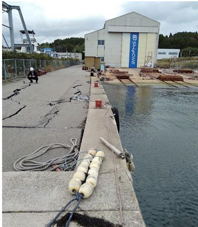
図 4-22 船台先端部 (R6年12月撮影) 被災後土砂の流出により表面舗装の割れが進行
