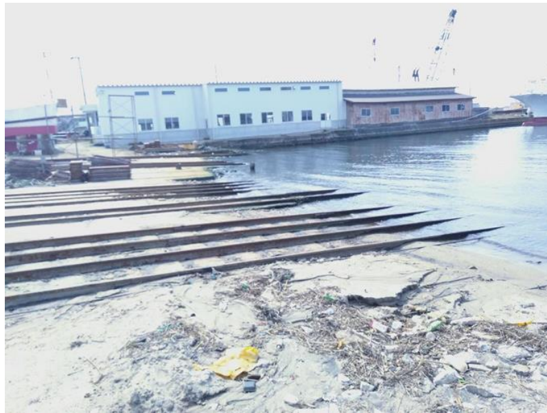
図 4-19 新工場（左側）と旧工場（中央部が沈下してたわみを発生）
