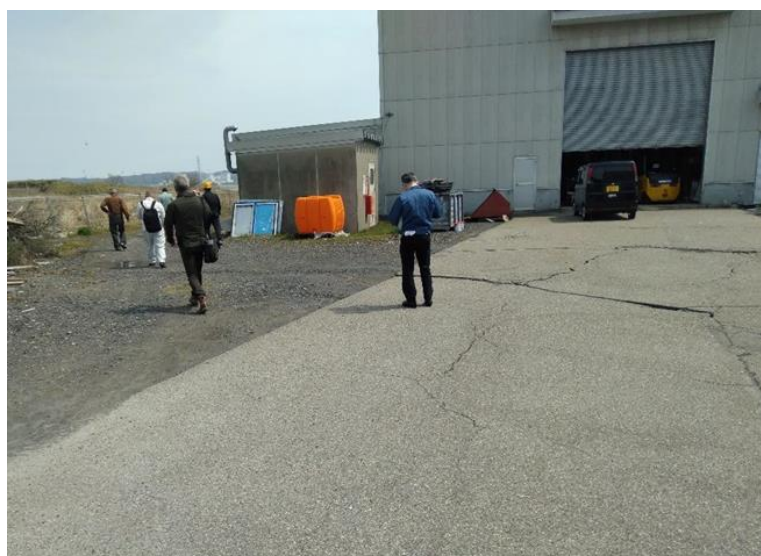
図 4-21 工場建屋前コンクリート舗装被災状況(砕石部地割れ他)
