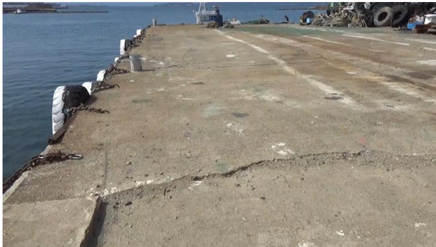
図 4-26 石川ドック岸壁（床板の若干のずれ、ヒビはあるが岸壁の倒れこみ等無し）
