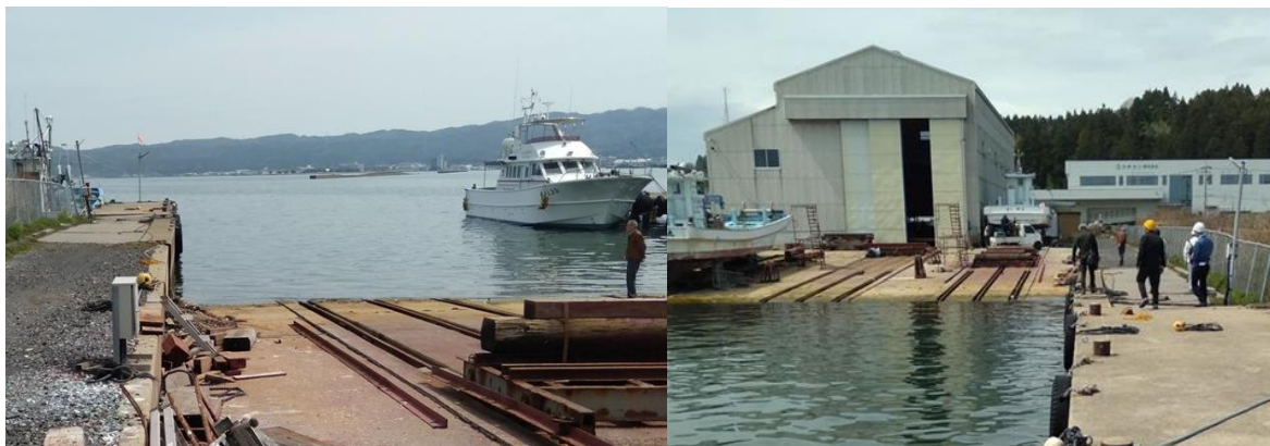
図 4-23 陸側から；船台レール変形状況、側面護岸変位状況（はらみ） 海側から；船台レール変形状況、側面護岸変位状況（はらみ）
