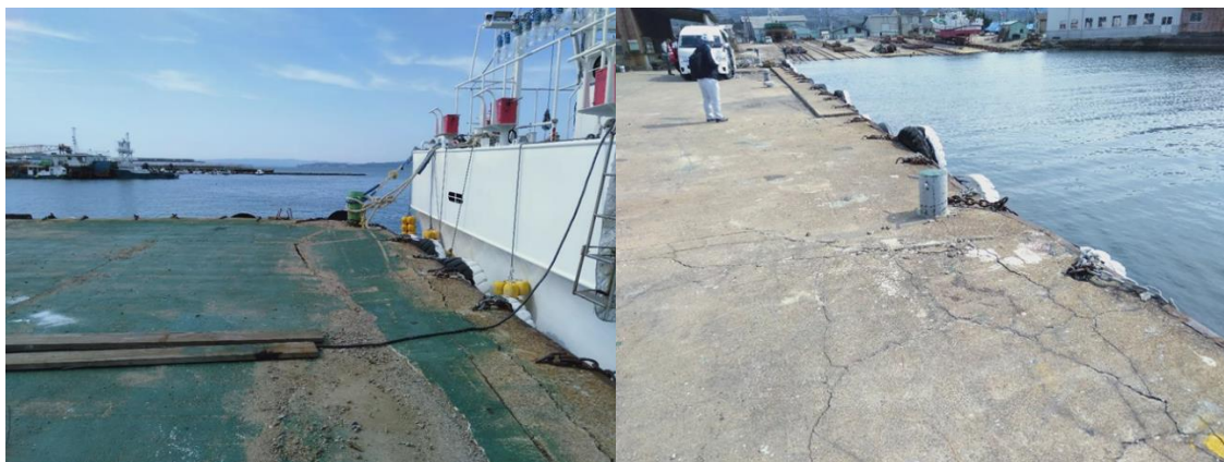
図 4-20 左岸方先端部ボラード（コンクリート床版の変形/沈下） 右岸方コンクリート床版沈下及び割れ
