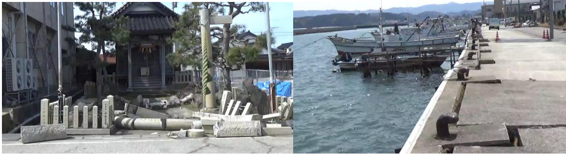
図 3-3 七尾市石崎漁港被災状況
