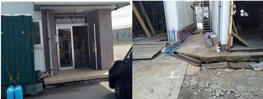
図 4-13 事務所建屋外周沈下約 10 cm、工場建屋被災状況（外周地盤沈下、建屋鉄骨歪み他）（4 月初旬下水道は未復旧）
