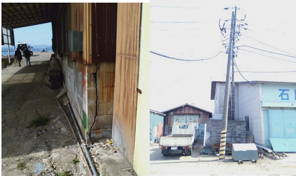
右岸方工場建屋(下壁)縦割れ、及び通路部クラック／工場引受電/電柱の倒れ(使用中)
