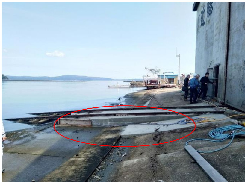
図 4-6 造船所側面たたき部コンクリート床版開き及び変形 (新造船の船台はコンクリートでかさ上げして修復済（約 30 cmかさ上げ）)
