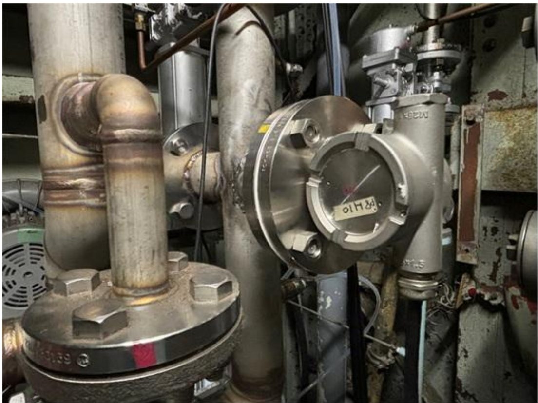
図 42-3. 配管に設置した水素センサー
