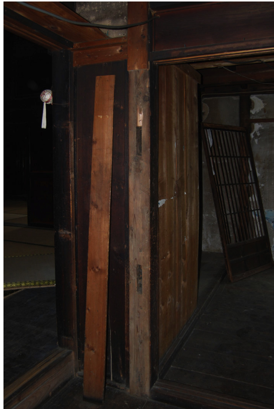
主屋 チャノマ背面棚柱 北東より 宛木を外すと貫の仕口痕跡があり壁に復原される
