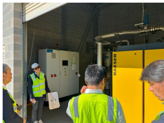
(コンプレッサー装置)
