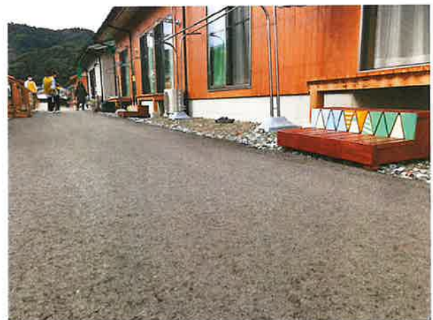
fig4.完成品を実際に設置した様子
