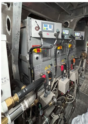
（バッテリーモニタリングパネル）
