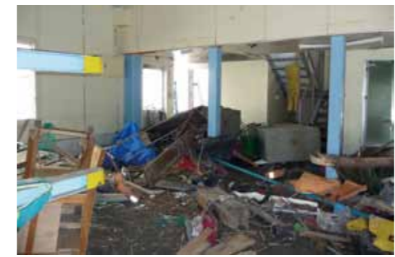
地震直後の艇庫内 (改修前)
