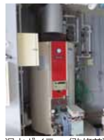
温水ボイラー (改修前)
