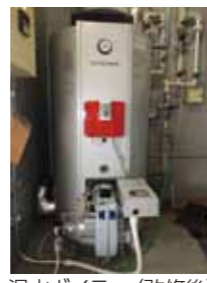
温水ボイラー (改修後)
