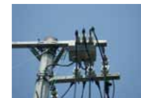
高圧開閉器 (改修前)
