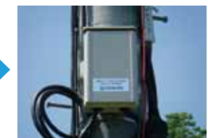
高圧開閉器 (改修後)
