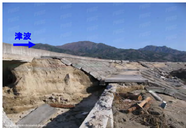
写真 2-6 土塁堤防の崩壊
