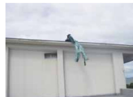
阿南市：体育館の屋根がめくれた
